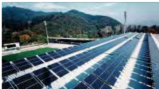
Ενσωμάτωση φωτοβολταϊκών σε γήπεδο ποδοσφαίρου
