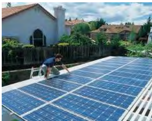
Εφαρμογή φωτοβολταϊκών σε σκέπαστρο
