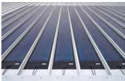
Εφαρμογή εύκαμπτων φωτοβολταϊκών άμορφου πυριτίου σε βιομηχανική στέγη
