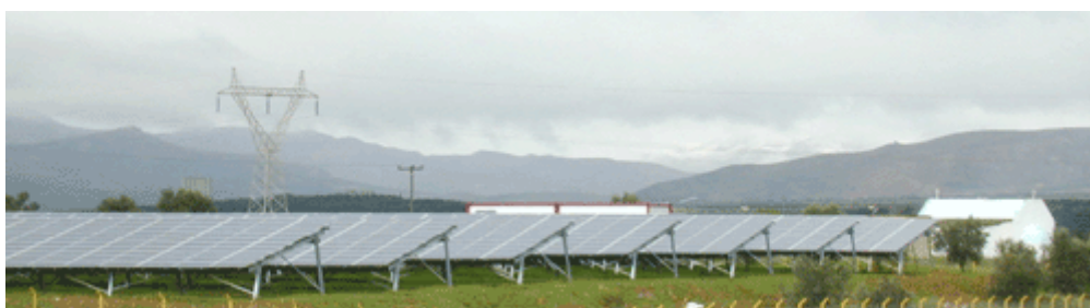
Φωτοβολταϊκός σταθμός ηλεκτροπαραγωγής (μεσαίου μεγέθους)
